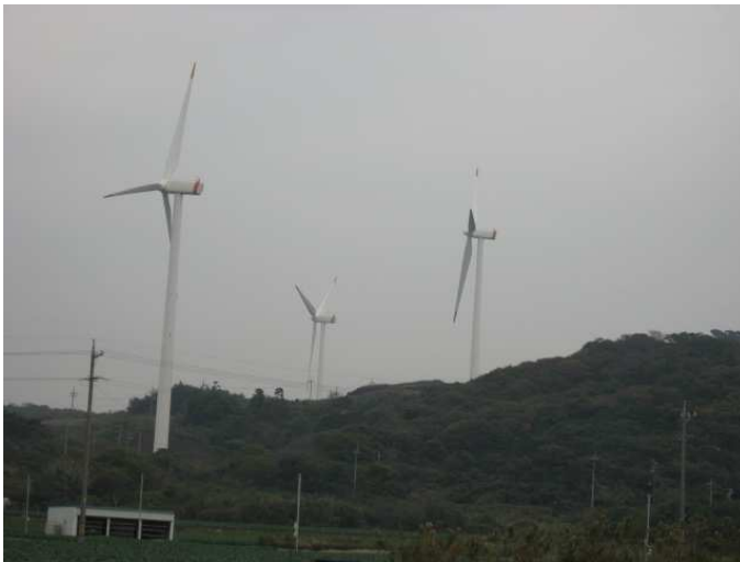
厚美風力発電所
